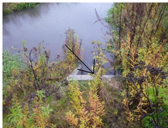
Fot. 5.2 Wylot nr 2 w km 7+370 rzeki Czechówki
